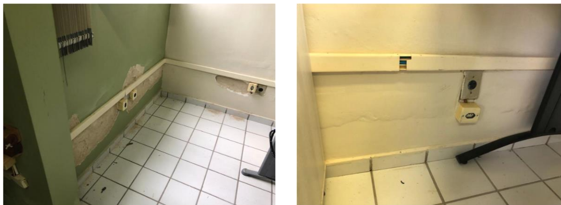
Figura 122: Infiltração na parede do Laboratório de Projetos Integrados
