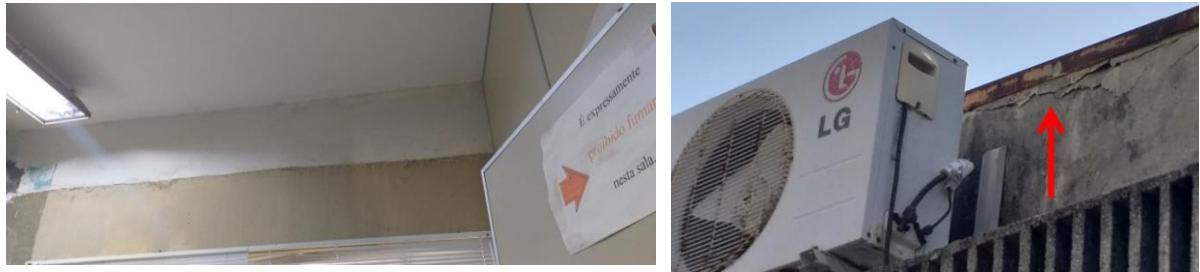
Figura 98: Vistas da Infiltração no Lab. Medidas Magnéticas 1
