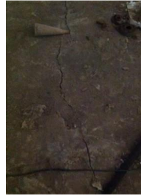
Figura 83: Deformação/rachadura na laje de cobertura do Laboratório de Processos Químicos Têxteis
