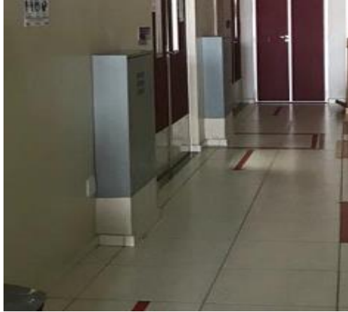
Figura 157: Caixas que abrigam reguladores de pressão na circulação e sem ventilação, 1º pavimento.
