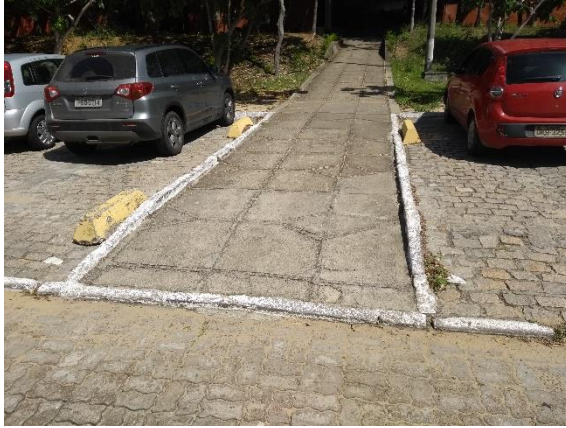
Figura 123: Acesso principal do CB a partir do estacionamento da Rua das Biociências
