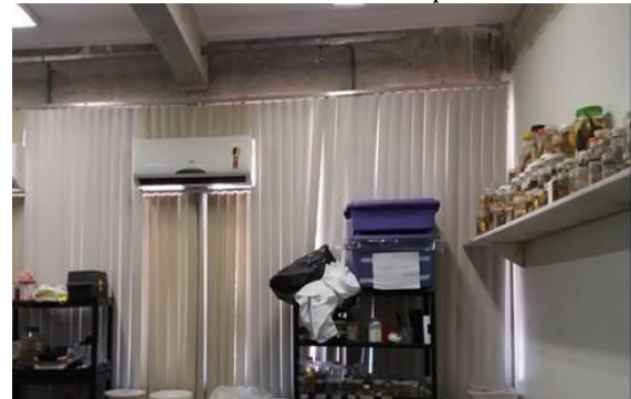
Figura 85: Deslocamento de concreto da viga do Laboratório de Fauna Aquática
