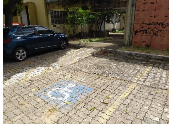
Figura 140: Vaga acessível inadequada aos padrões exigidos normativamente
