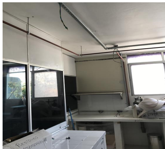
Figura 168: Momento da revisita, instalações elétricas novas bem como rede de gás G.L.P
