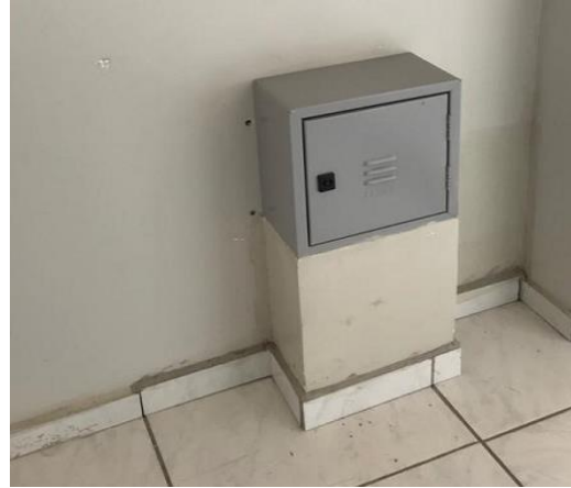
Figura 158: Caixas que abrigam reguladores de pressão na circulação e sem ventilação, 2º pavimento.
