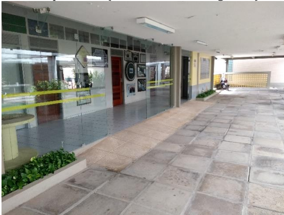
Figura 137: Entrada de ambiente com rampamento (fora das normas vigentes)
