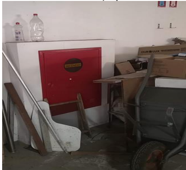
Figura 149: Localização de hidrante obstruído e falta de extintores no local onde há sinalização para os mesmos.
