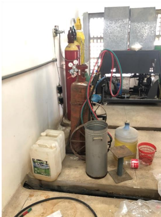
Figura 105:- Situação atual - Presença de gases explosivos próximo as instalações elétricas.
