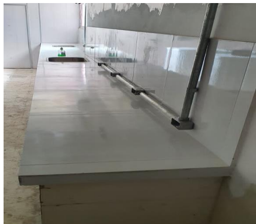
Figura 166: Momento da revisita: piso retirado e porcelanato aplicado sobre as bancadas e alvenarias, instalações elétricas novas bem como rede de gás G.L.P
