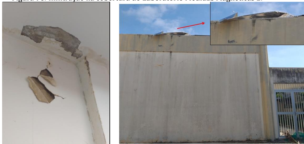
Figura 96: Infiltração na cobertura do Laboratório Medidas Magnéticas 2.
