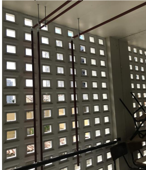
Figura 172: Tubulação de gás G.L.P aparente, no local onde será a nova caixa para reguladores de pressão no 1º pavimento
