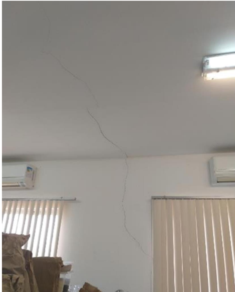
Figura 110: Trinca inclinada em alvenaria esse prolongando para o forro.
