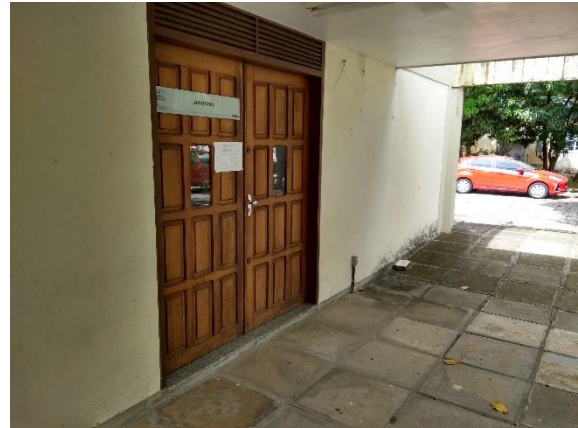
Figura 138: Desnível em degrau na entrada de um auditório
