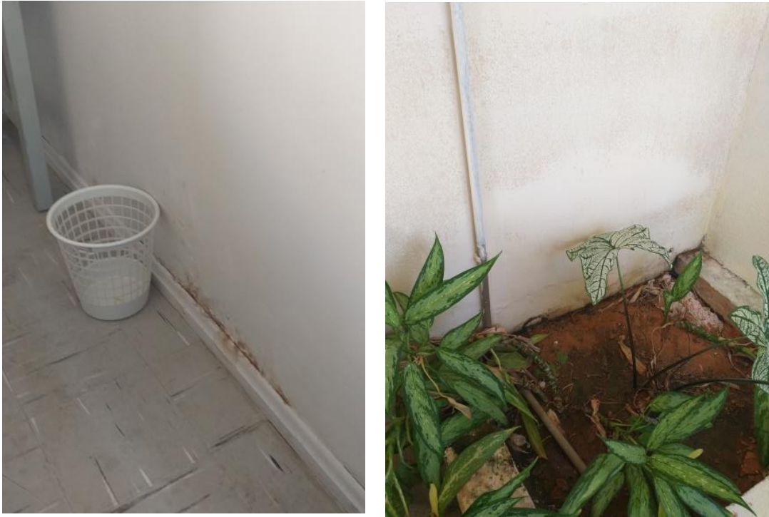
Figura 97: Infiltração nas jardineiras externas Lab. Filmes Finos.
