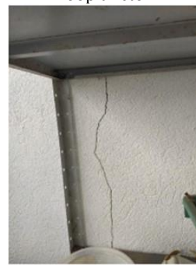
Figura 81: Trinca em alvenaria externa sem amarração adequada no Laboratório de Cultivo de Zooplâncton
