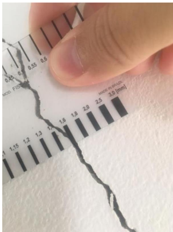
Figura 112: Abertura de rachadura em elemento de alvenaria (1,6 mm).
