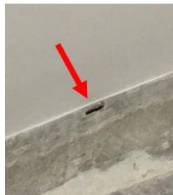
Figura 77: laboratório com armadura exposta
