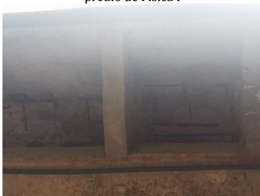
Figura 142: Ferragens expostas cobertura do prédio de Física I
