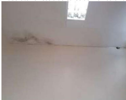
Figura 79: laboratório com infiltrações na laje Laboratório Escola do Curso de Biomedicina
