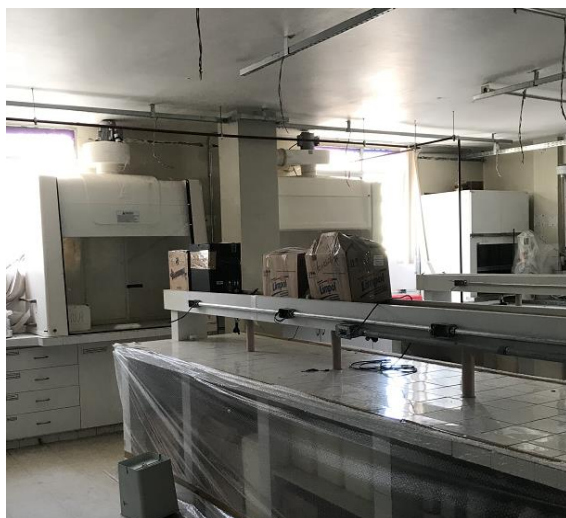
Figura 167: Momento da revisita, instalações elétricas novas bem como rede de gás G.L.P
