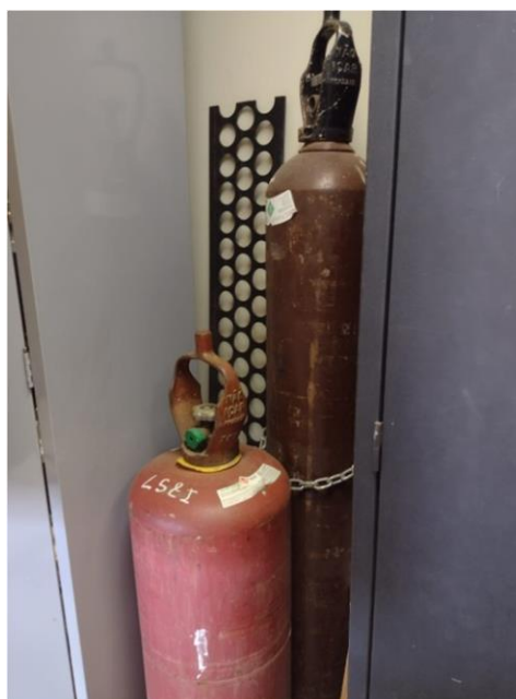
Figura 119: Cilindros de Gás Acetileno, Oxigênio, CO2 e Argônio dentro do laboratório na vista em 2021.
