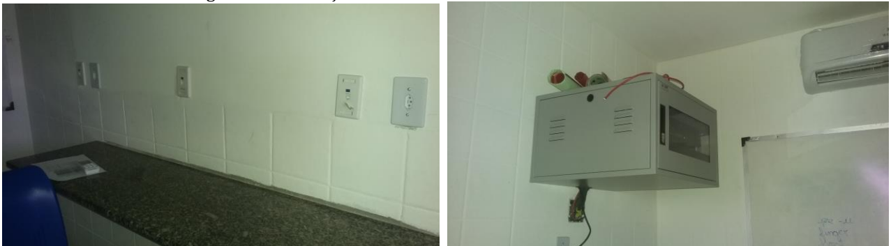
Figura 06: Instalações elétricas e cabeamento do Laboratório de Estudos
