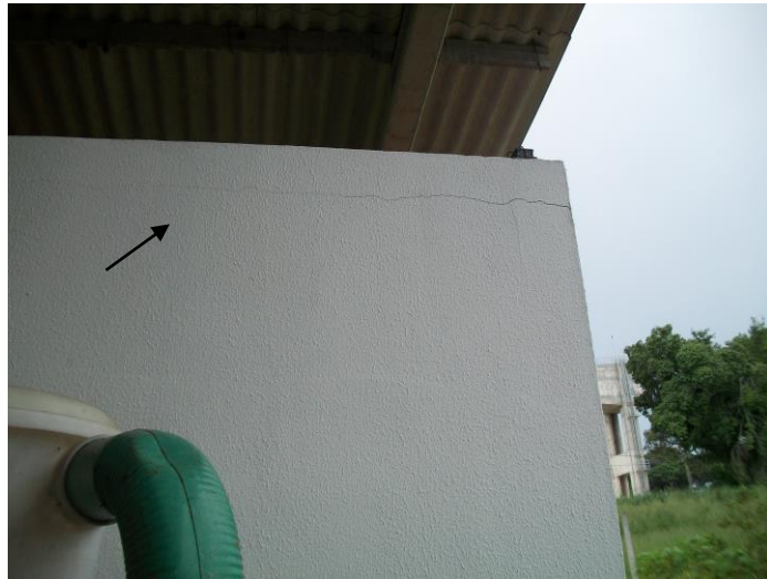
Figura 30: Fissura no encontro laje-parede
