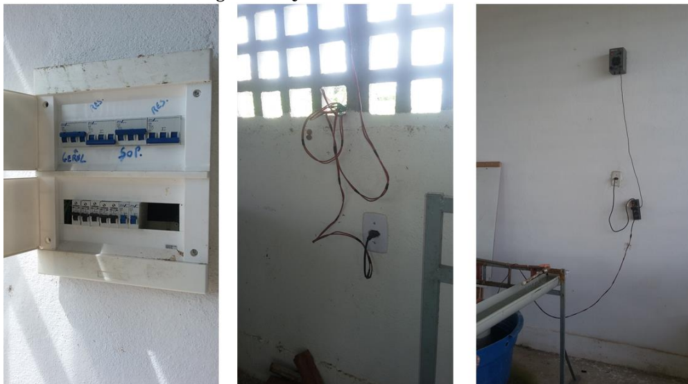
Figura 07: Quadro elétrico e tomadas
