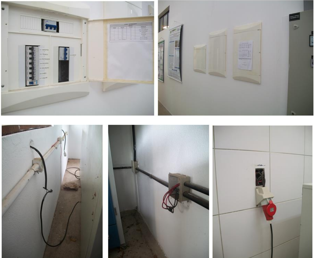
Figura 29: Instalações elétricas e cabeamento do Laboratório de Nutrição Animal
