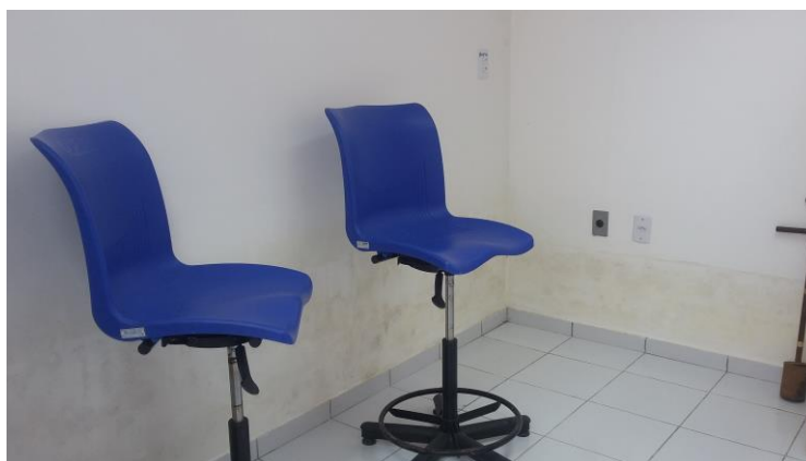
Figura 07: Paredes com infiltrações
