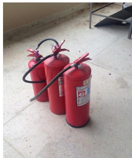
Figura 26: Extintores no piso do galpão
