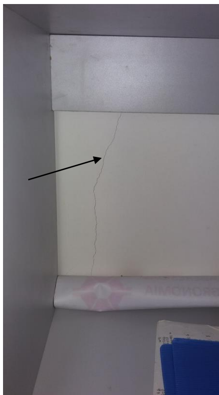
Figura 06: Fissuras nas alvenarias
