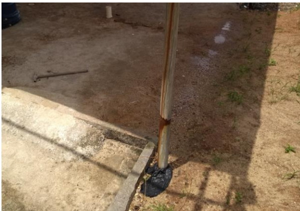
Figura 16: Estrutura metálica corroída
