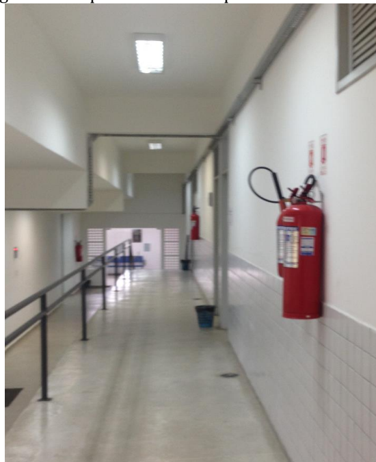
Figura 12: Dupla de extintores próxima ao laboratório
