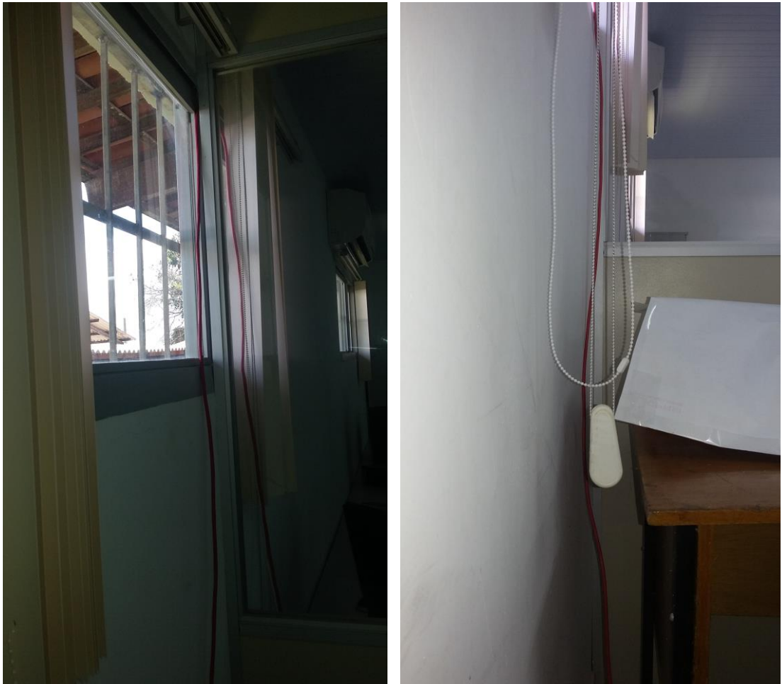
Figura 05: Desorganização dos cabos elétricos
