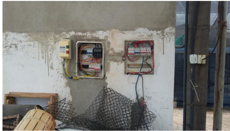
Figura 15: Aspectos das instalações elétricas e cabeamento do Laboratório de Carcinicultura.
