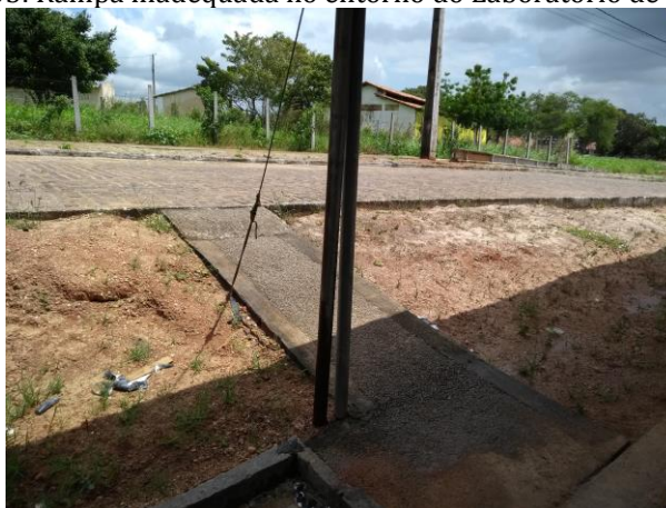
Figura 05: Rampa inadequada no entorno do Laboratório de Carcinicultura
