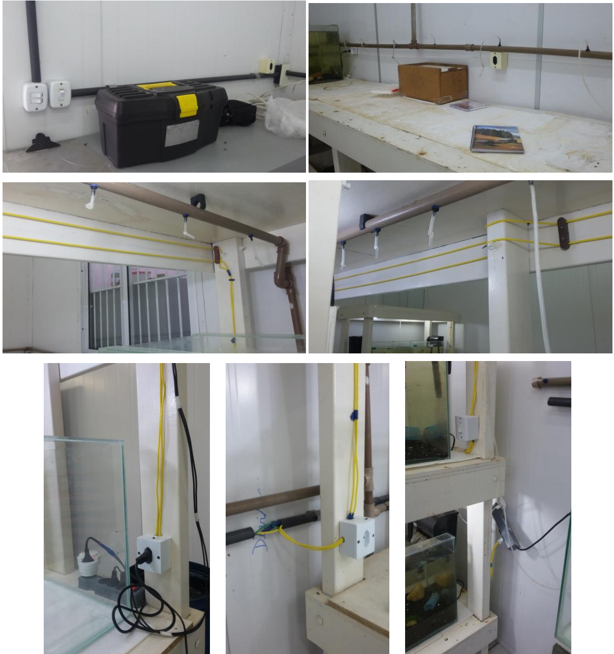
Figuras 08 a 14: Aspectos das instalações elétricas e cabeamento do Laboratório de Carcinicultura.
