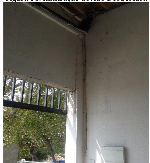
Figura 06: Infiltração devido a cobertura
