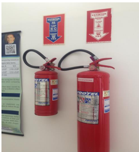
Figura 25: Extintores na circulação da edificação.
