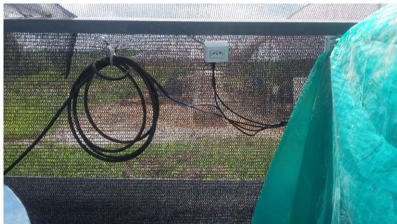
Figuras 09, 10 e 11: Aspectos das instalações elétricas e cabeamento do laboratório.
