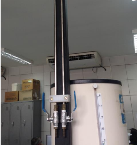
Figura 10: Tubulação de gases especiais
