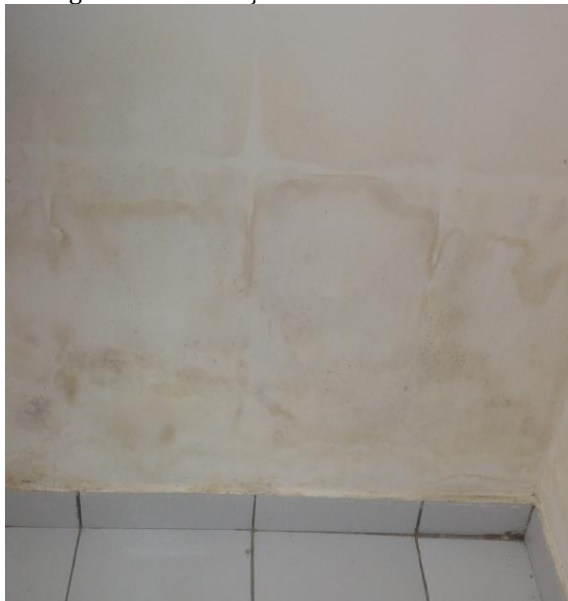
Figura 04: Infiltrações dentro do laboratório
