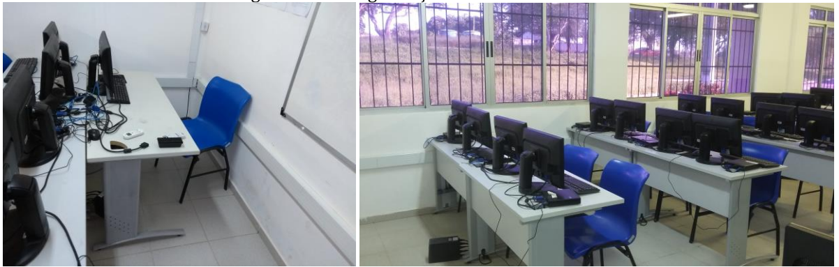
Figura 05: Desorganização dos cabos elétricos
