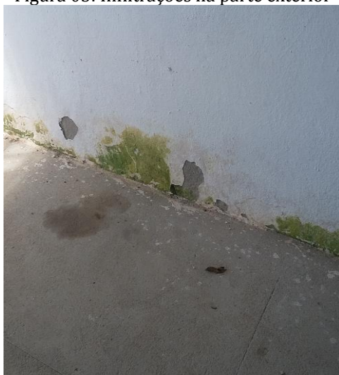
Figura 05: Infiltrações na parte exterior
