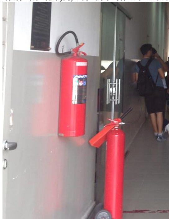
Figura 04: Extintores na circulação, mas não existem luminárias de emergência
