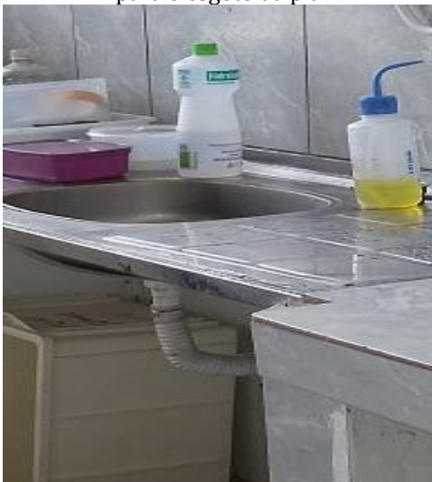
Figura 03: Sifonamento inadequado para o esgoto da pia
