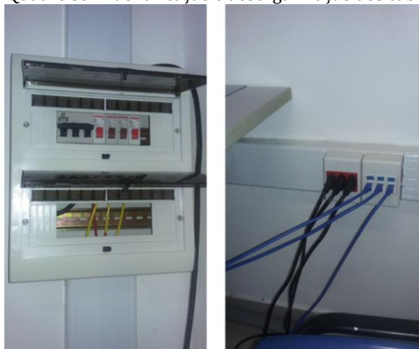
Figura 04: Quadro sem identificação e desorganização dos cabos elétricos
