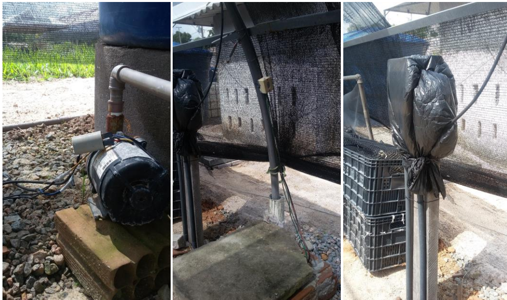
Figuras 06, 07 e 08: Aspectos das instalações elétricas e cabeamento do laboratório.
