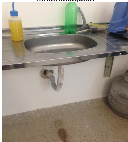
Figura 20: pia com tubulação do sifão fora de norma, inadequado.
