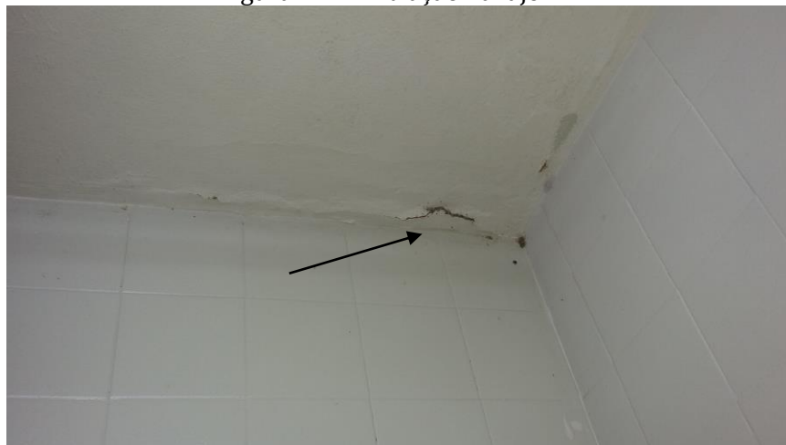
Figura 12: Infiltração na laje
