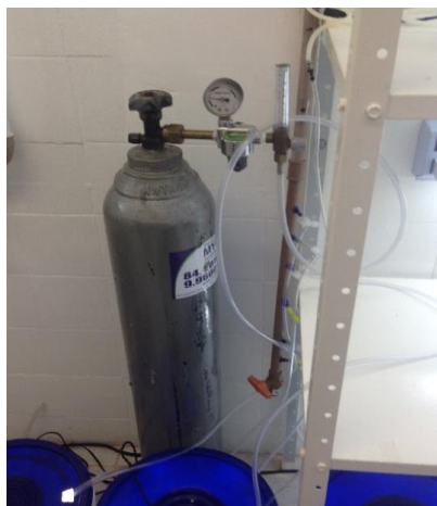
Figura 09: Gases medicinais no interior do laboratório, sem a corrente de segurança
