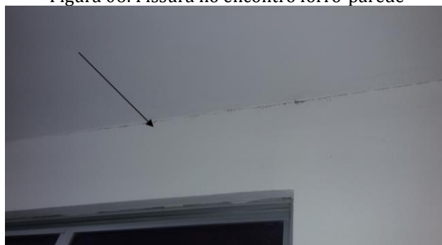
Figura 06: Fissura no encontro forro-parede
