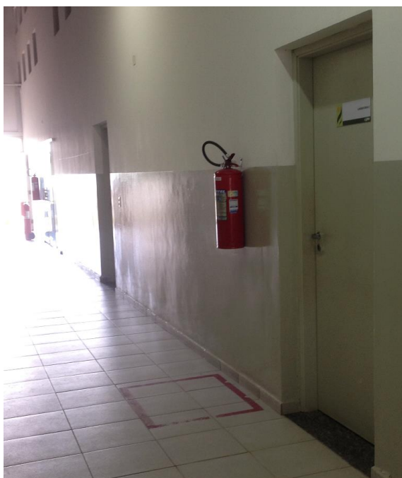
Figura 04: Extintores próximos ao laboratório
