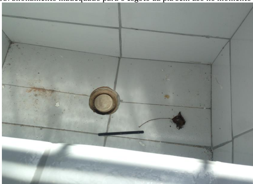
Figura 03: Sifonamento inadequado para o esgoto da pia sem uso no momento da visita.
