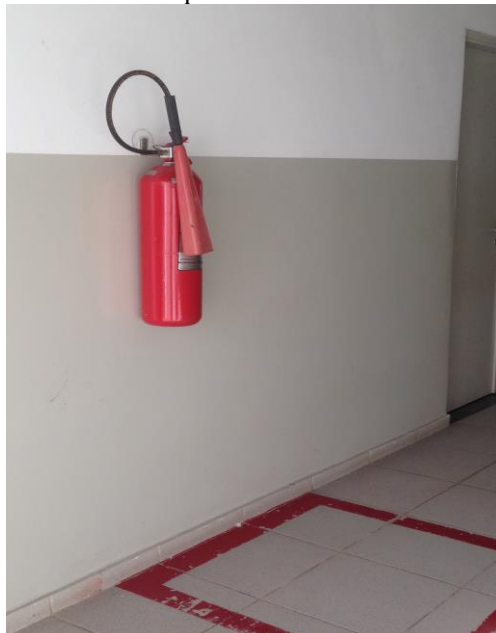
Figura 04: Extintor próximo ao laboratório recarregados.
