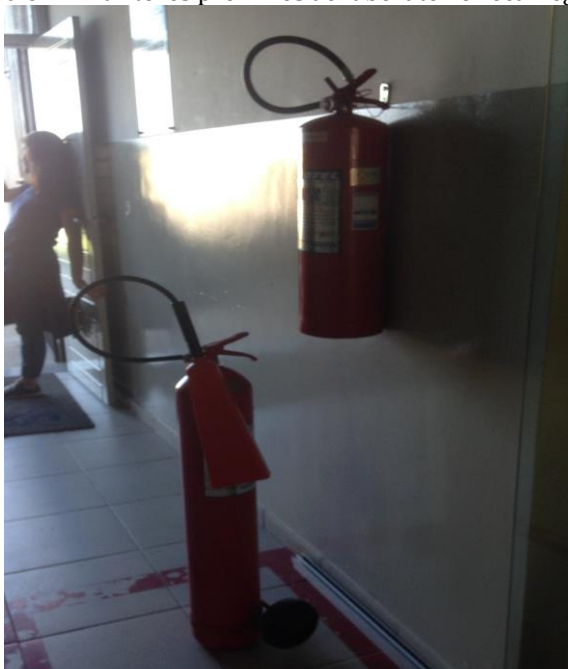
Figura 04: Extintores próximos ao laboratório recarregados.
