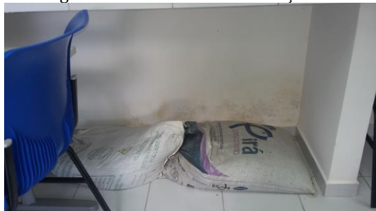
Figura 06: Paredes com infiltrações
