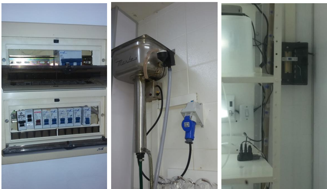
Figura 11: Aspectos das instalações elétricas do Laboratório
