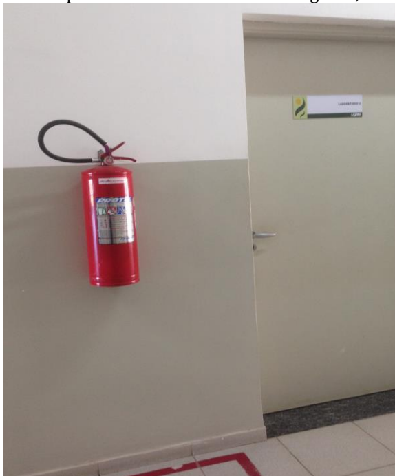
Figura 04: Extintor próximo ao laboratório recarregados, sem sinalização.
