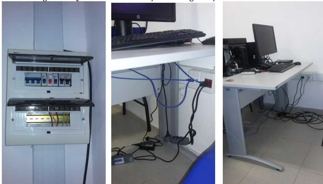
Figura 05: Quadro sem identificação e desorganização dos cabos elétricos
