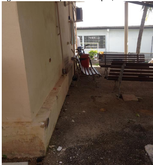
Figura 08: Infiltração nos rodapés, área externa
