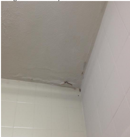
Figura 07: Infiltrações devido a cobertura
