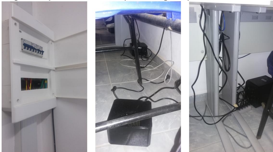
Figura 05: Quadro sem identificação e desorganização dos cabos elétricos
