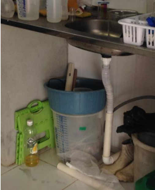
Figura 06: Esgoto sem o sifão
