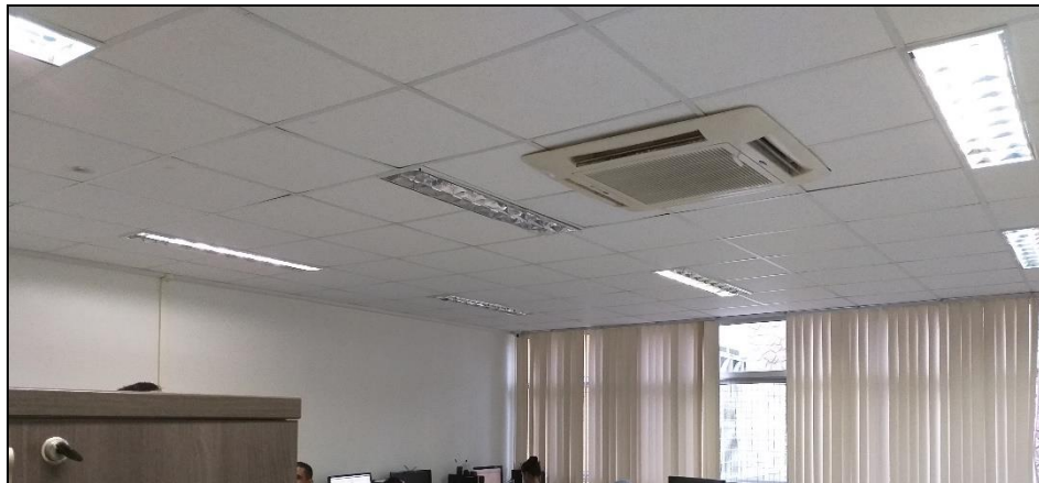
Figura 9: - Luminárias do laboratório
