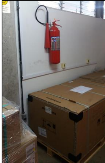
Figura 14: Caixotes impedindo o acesso ao extintor
