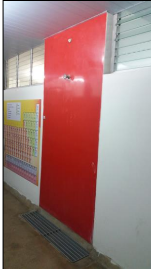
Figura 12: Instalação para chuveiro de emergência, porém sem o chuveiro.
