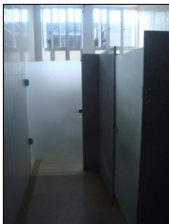
Figura 16: Corredor no banheiro. Todas as portas para os sanitários são de vidro jateado e possuem maçaneta de abertura inadequada
