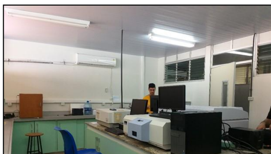
Figura 10: - Luminárias do laboratório
