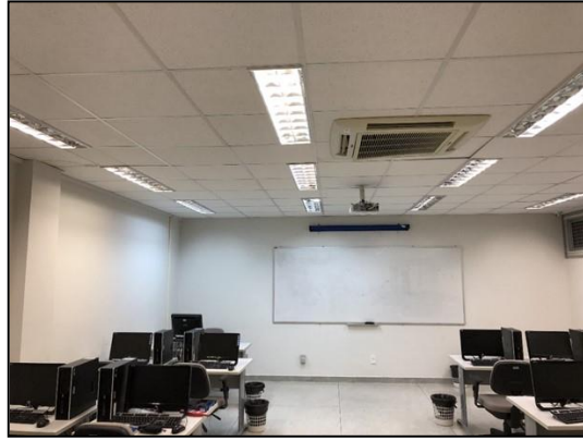
Figura 8: - Luminárias do laboratório
