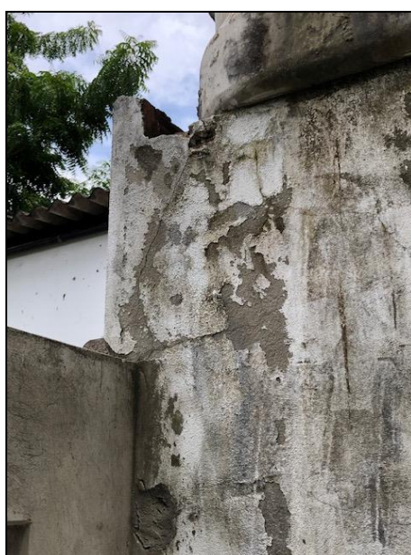
Figura 29: Fissuras em paredes de apoio para reservatório de fibra.
