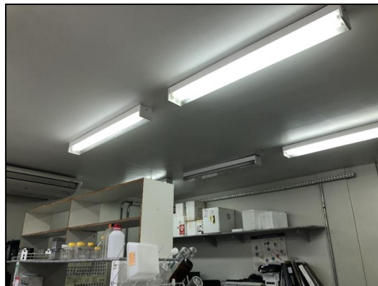
Figura 19: Luminárias do laboratório
