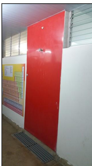
Figura 13: Instalação para chuveiro de emergência, porém sem o chuveiro.
