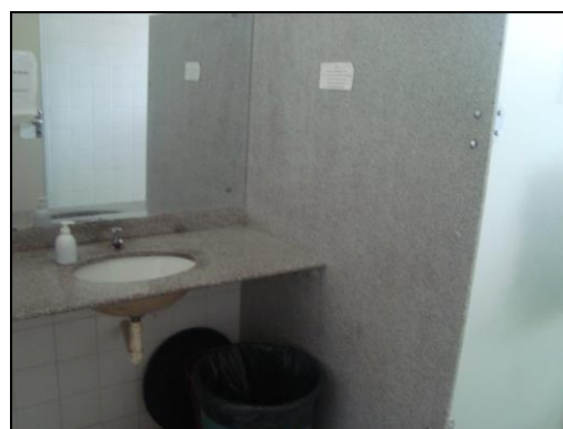
Figura 17: Pia com altura inadequada
