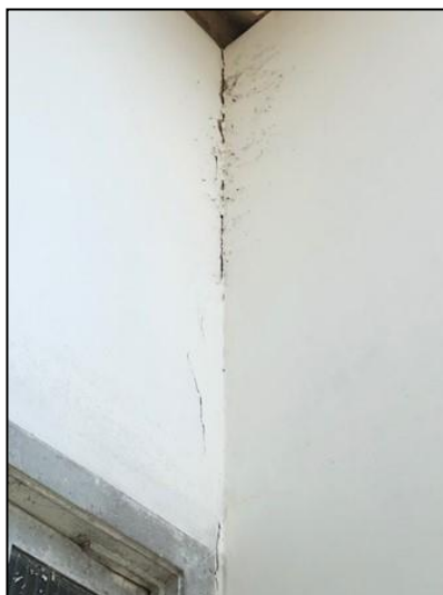
Figura 19: Fissuras verticais entre edificação principal e abrigo para condensadoras
