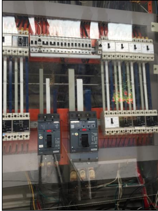
Figura 12: Quadros elétrico do laboratório
