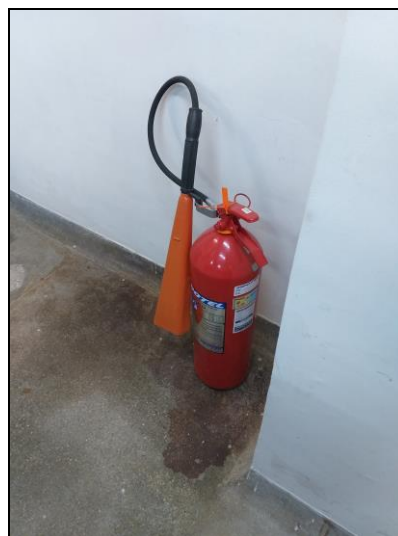
Figura 15: Extintor de CO2 no chão.
