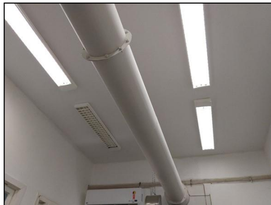
Figura 13: - Luminárias do laboratório
