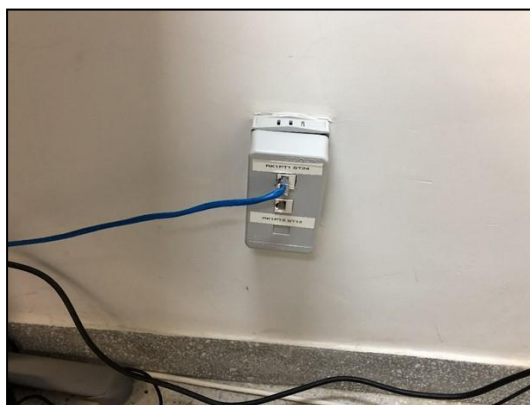
Figura 10: Porta equipamentos instalado em canaleta.
