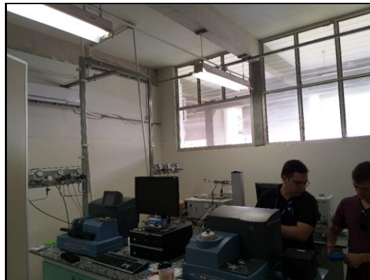
Figura 10: - Luminárias do laboratório
