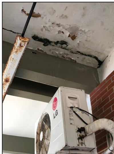
Figura 16: Infiltração em laje de cobertura.
