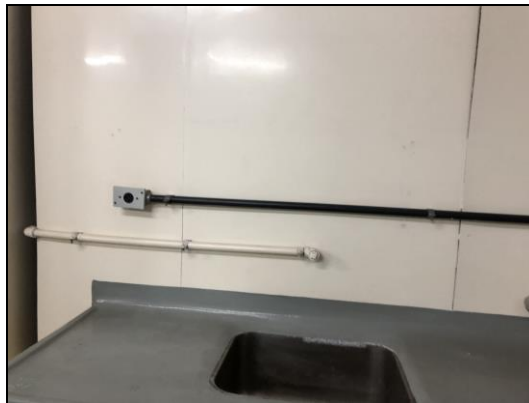
Figura 13: Pia sem torneira de água fria.
