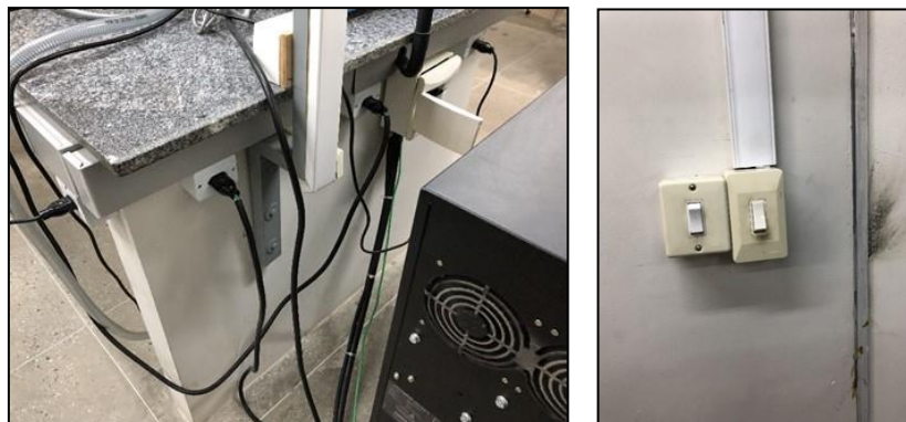
Figura 9: Tomadas no padrão novo e interruptores sem identificação.
