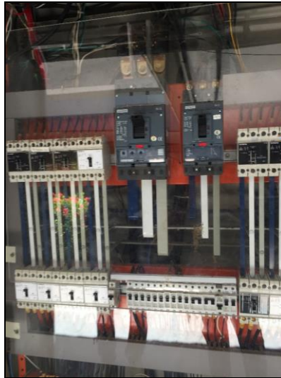
Figura 11: Quadros elétrico do laboratório
