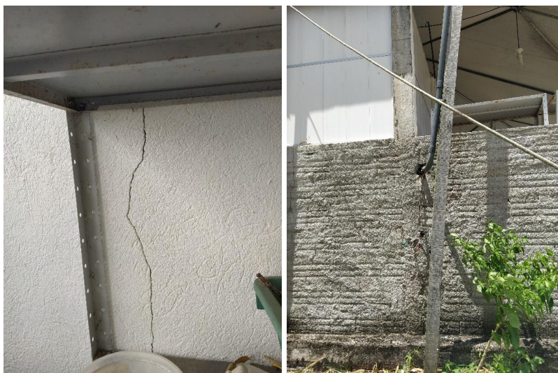
Figura 11: Parede com trincas e ausência de revestimento externo.
