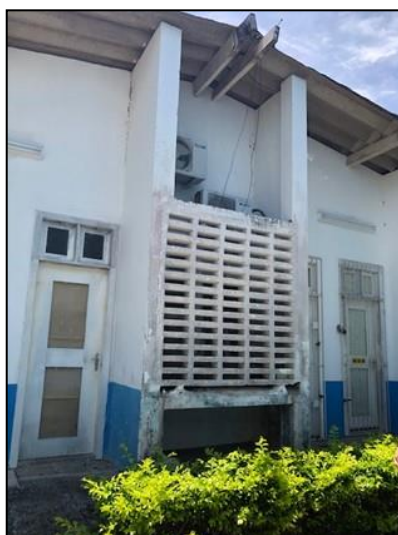
Figura 20: Vista da fachada frontal e existência de alvenarias para abrigo de condensadoras
