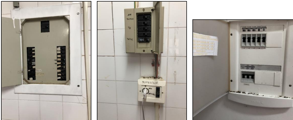
Figura 27: Quadros elétricos do Núcleo
