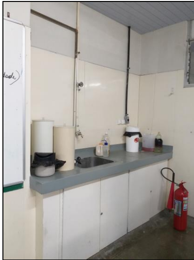
Figura 14: Extintor de CO2 no chão
