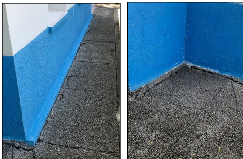
Figura 18: Recalque de calçada localizada no perímetro da edificação
