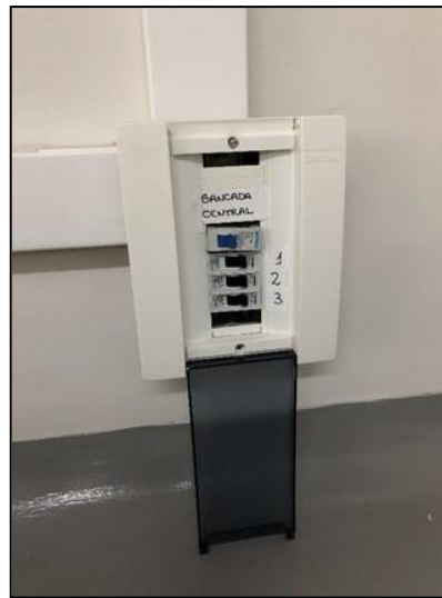
Figura 11: Quadros elétrico que atende o laboratório.
