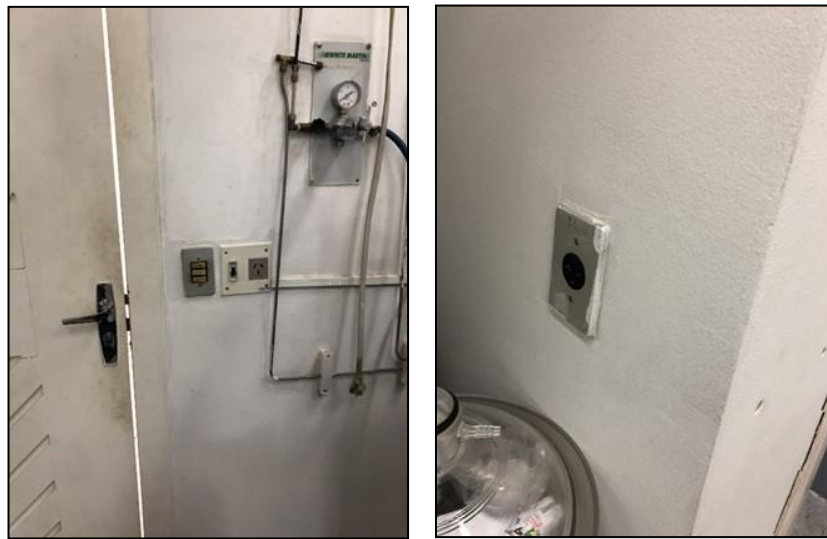
Figura 12: Interruptor desgastado e tomada no padrão antigo
