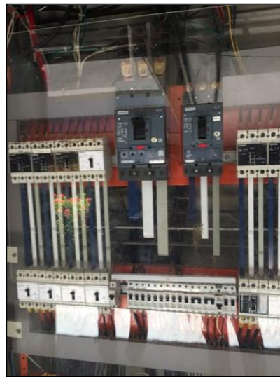
Figura 11: Quadros elétrico que atende o laboratório.
