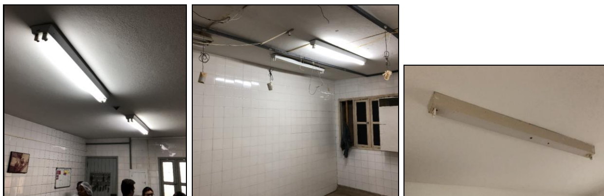
Figura 26: Luminária com lâmpadas queimadas.
