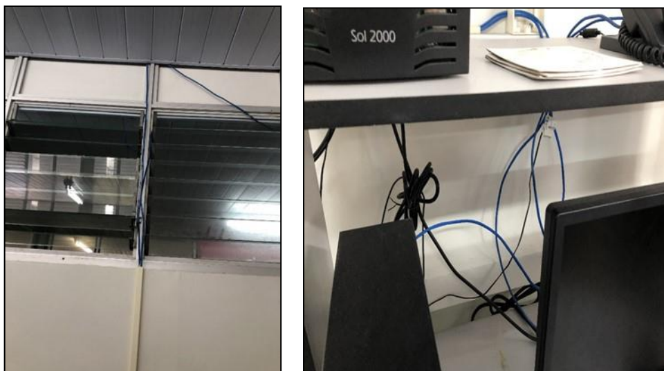
Figura 12: Cabeamento estruturado exposto sem a utilização de dutos.
