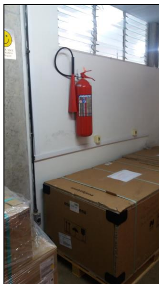
Figura 13: Caixotes impedindo o acesso ao extintor.
