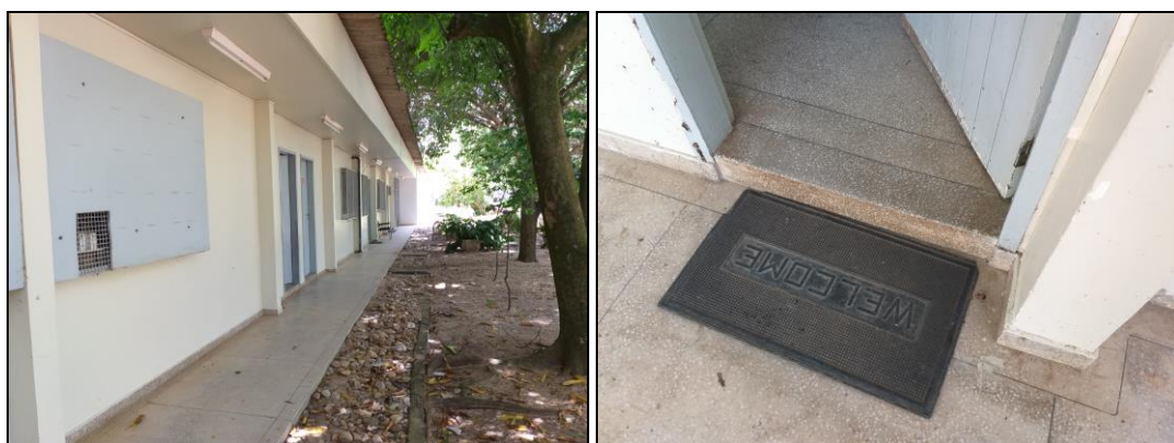
Figura 19: Desníveis no acesso as salas.
