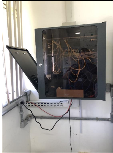
Figura 22: Rack que atende o laboratório.
