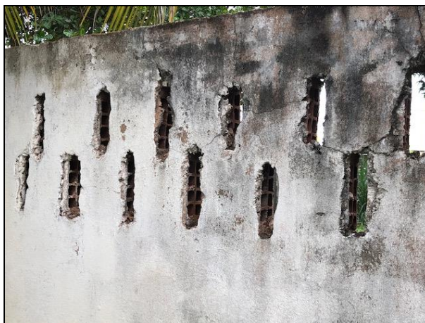
Figura 30: Fissuras em muro interno.
