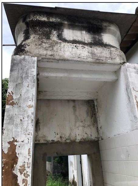
Figura 28: Reservatório superior em fibra apoiado em vigas de concreto armado fissuradas.
