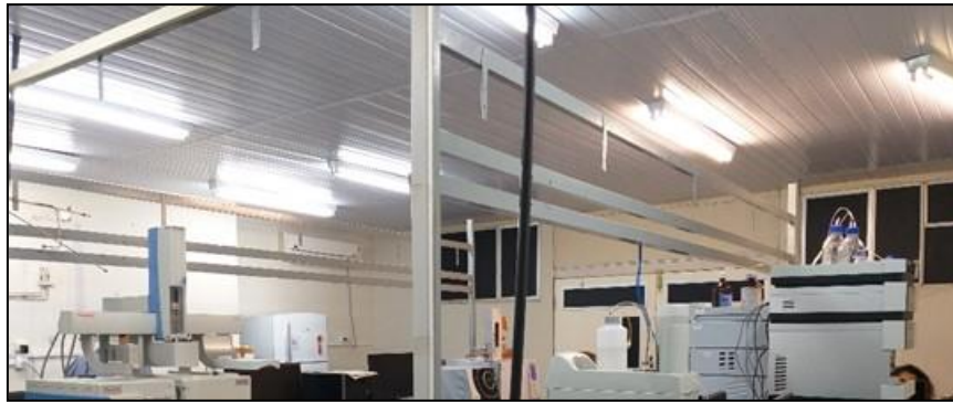
Figura 10: - Luminárias do laboratório
