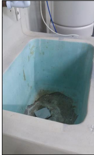
Figura 14: Tanque com revestimento danificado.
