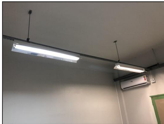
Figura 10: - Luminárias do laboratório
