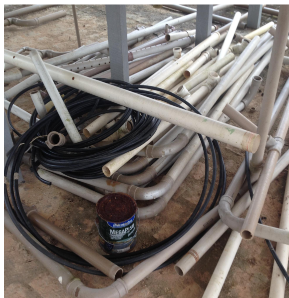
Figura 04: Retirar as tubulações acumuladas e sem uso.
