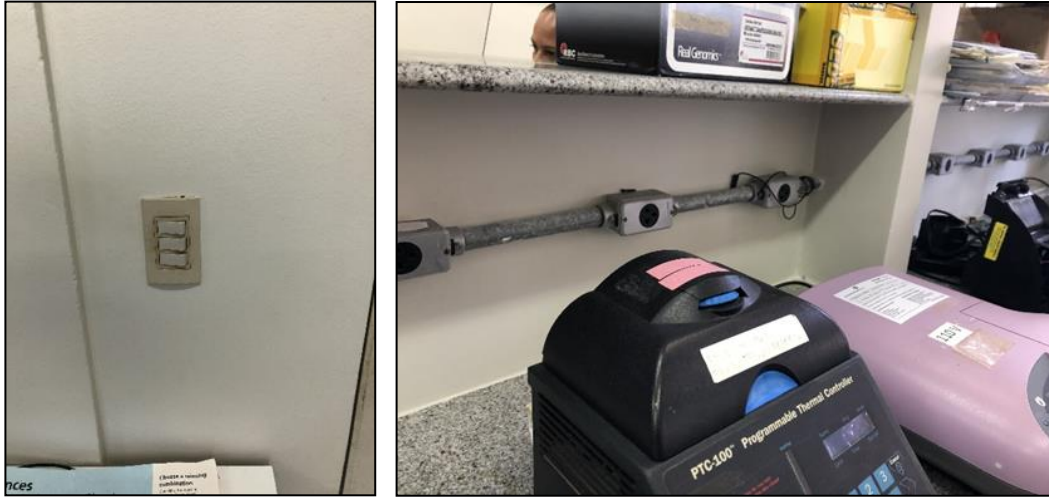
Figura 18: : Interruptor desgastado e tomadas no padrão antigo.
