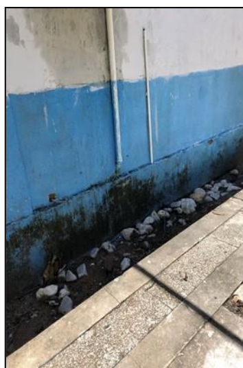
Figura 17: Infiltração na parede externa da edificação.
