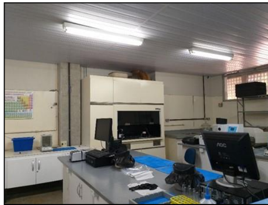
Figura 10: - Luminárias do laboratório
