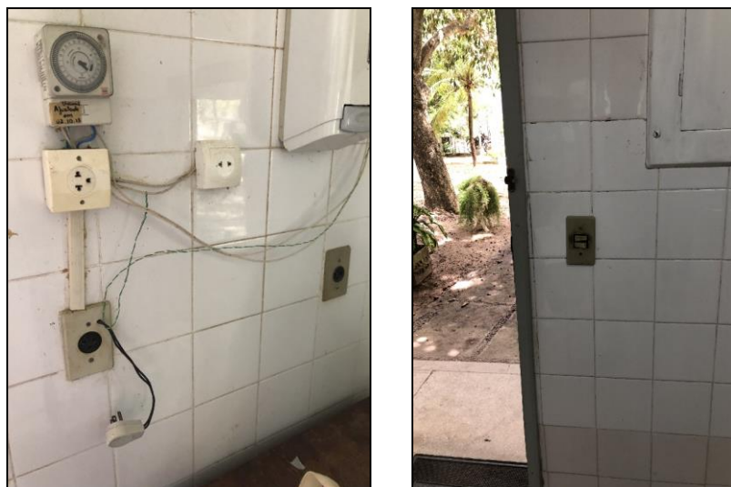
Figura 25: Tomadas no padrão antigo e interruptor que aciona as lâmpadas do Laboratório.
