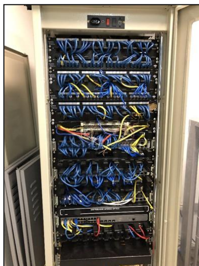
Figura 11: Rack que atende o laboratório
