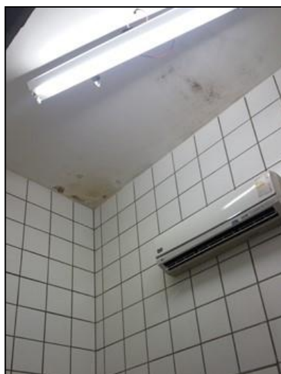
Figura 16: Infiltração na laje de cobertura.
