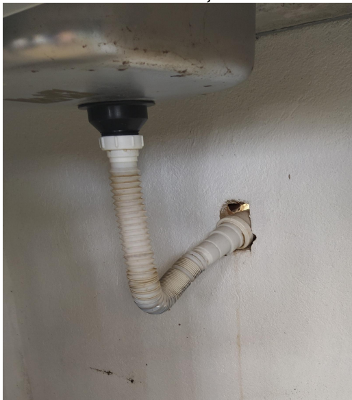
Figura 05: Esgoto sem o fecho hídrico e passagem da tubulação para área externa sem vedação.
